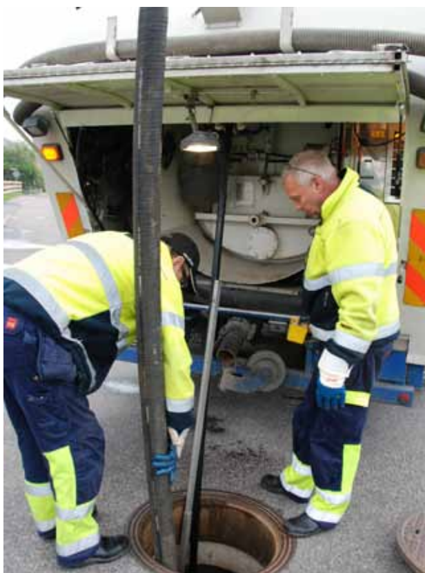
VA-avdelningen spolrar regelbundet ledningsnätet för att det inte ska bli stopp i rören.
