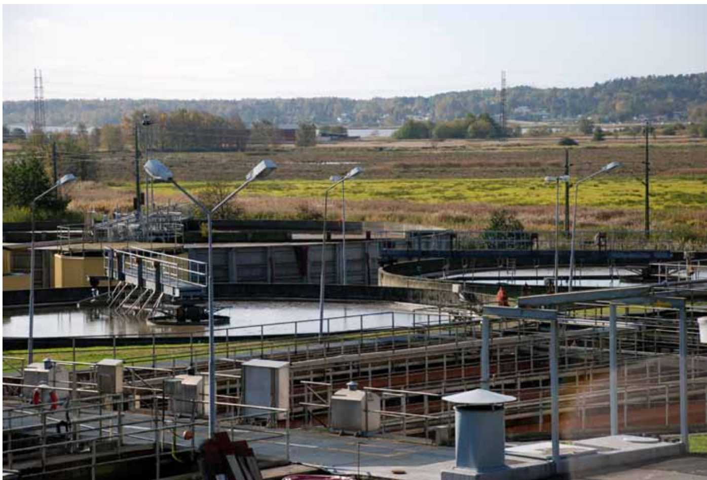
Hammargårds reningsverk ligger uppströms Kungsbackaåns mynning i Kungsbackafjorden.
